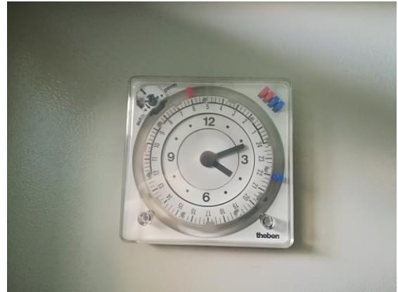
Figura 4.6 – Orologio a servizio dell'impianto termico
