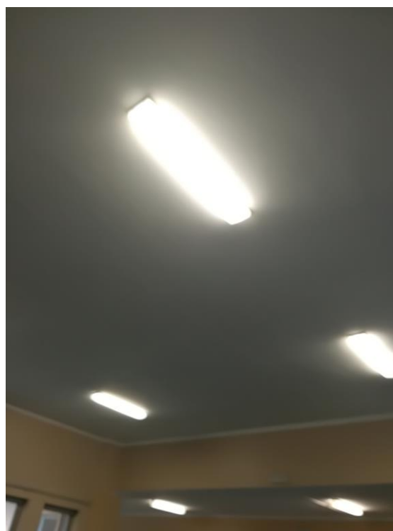
Figura 4.11 - Particolare dei corpi illuminanti ubicati nelle aule
