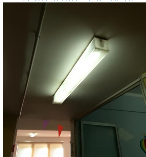
Figura 8.13 - Particolare di una lampada fluorescente attualmente installata
