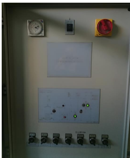
Figura 4.5 - Particolare del pannello di controllo di dell'impianto termico
