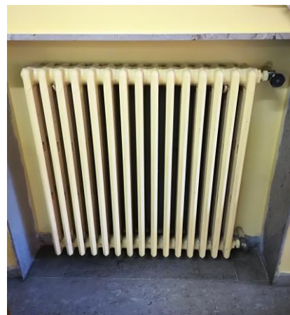
Figura 8.9 - Particolare della radiatore
