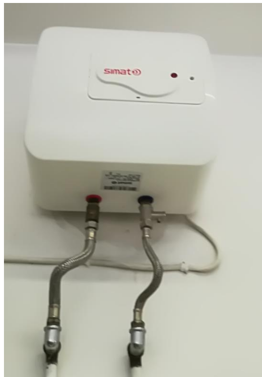
Figura 4.10 - Particolare di un boiler elettrico per la produzione di acqua calda sanitaria
