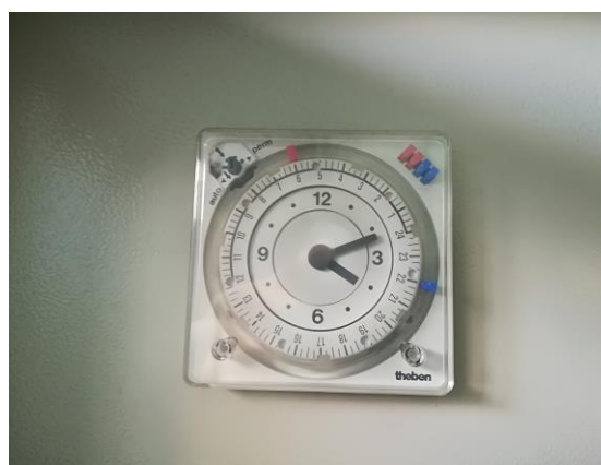
Figura 4.6 – Orologio a servizio dell'impianto termico
